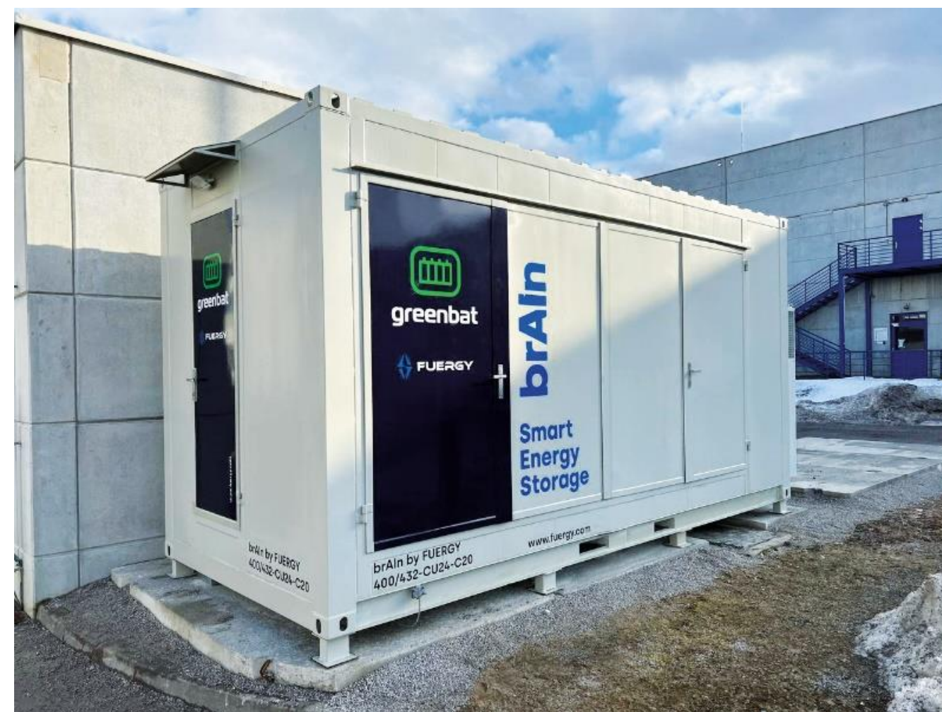
432 kWh úložisko. Zdroj: www.fuergy.sk
